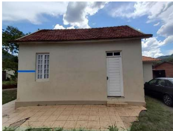
Figura 13- Marca de inundação em moradia na Linha Palmas atingida no evento de maio de 2024. Setor RS_ENCANTA_SR_045_SGB.
